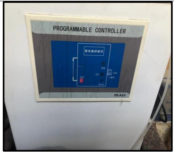
一体化污水处理设备
